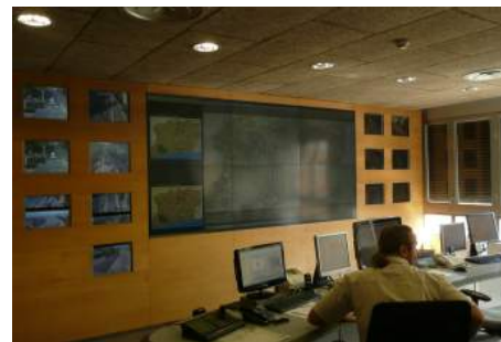
Barcelonské centrum kontroly dopravy
